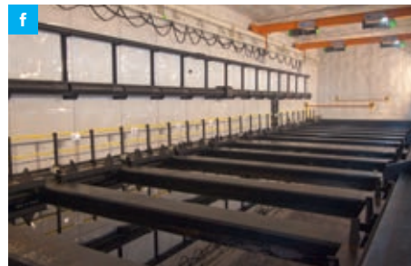
Vorbehandlungslinie von innen mit Wandverkleidung aus Polyethylen
